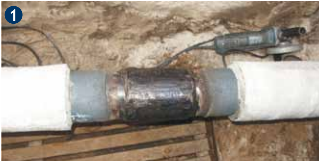
Rohrvorbereitung nach GW 15, sauber, trocken und fettfrei. Bei Schrumpfschläuchen-Manschetten, Vorwärmung auf 70 °C
